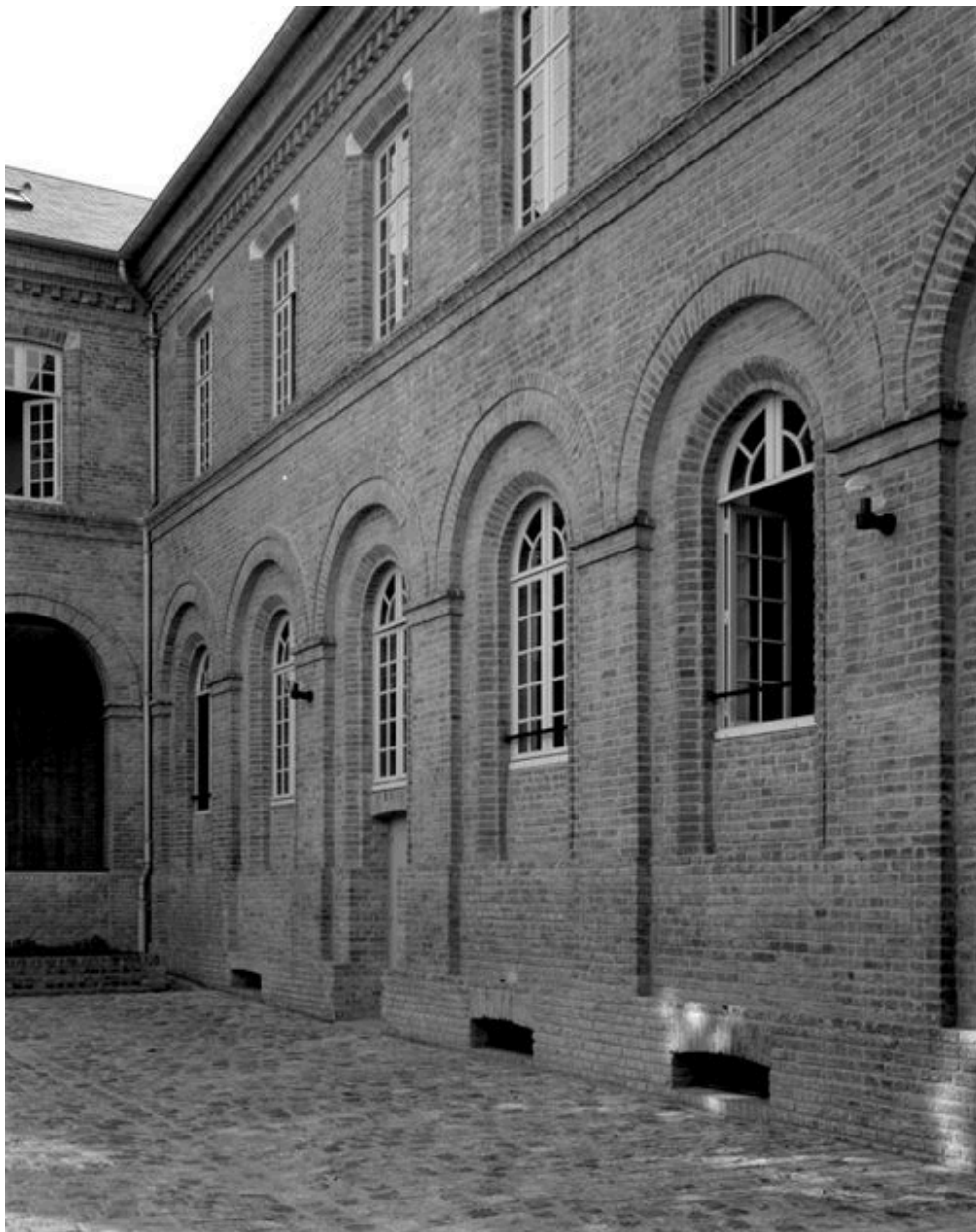
Façades sur la cour dite des Provisions, en 1983. Ancien cloître (rez-de-chaussée), bibliothèque, archives et dortoir (étage) devenus salles de classe.
