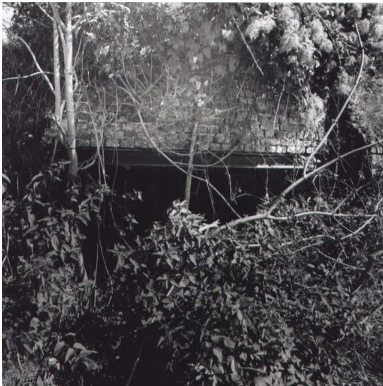
Entrée de la galerie d'extraction de la chaux, creusée dans la carrière voisine.
