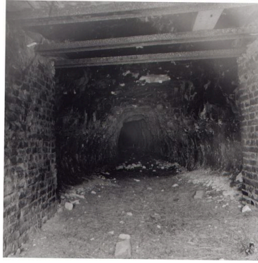
Intérieur de la galerie d'extraction dans la carrière de craie. Phot. Thierry Lefébure IVR22_20026000857X
