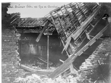
Les ateliers en ruine, par M. Chapelon, vers 1919 (AD Aisne). Phot. Pillet Frédéric IVR22_20060205704NUCAB
