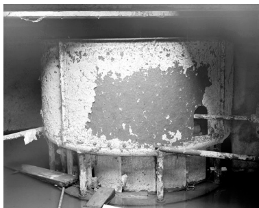
Bâtiment d'eau, turbine hydraulique. Phot. Thierry Lefébure IVR22_19908001833X
