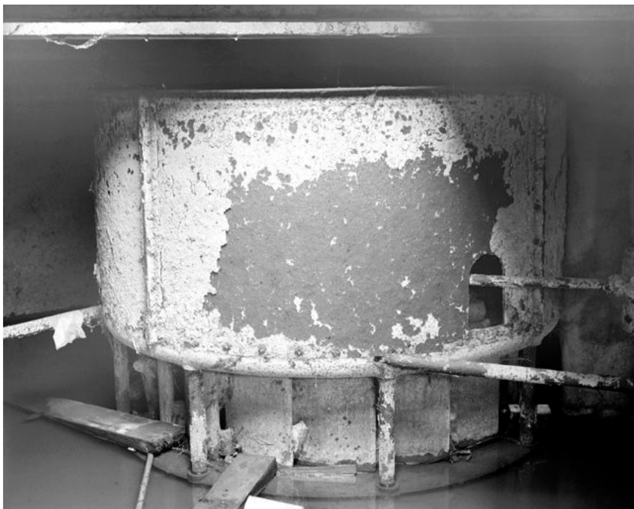
Bâtiment d'eau, turbine hydraulique.
