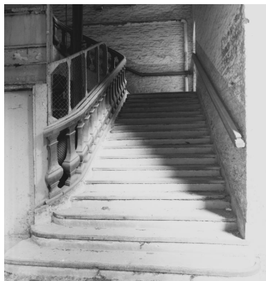
Escalier situé à l'angle du bâtiment fermant le fond de la cour d'honneur et de celui situé à gauche en entrant dans cette même cour et donc sur le flanc nord, départ. Phot. Philippe Dapvril IVR31_20005900512X
