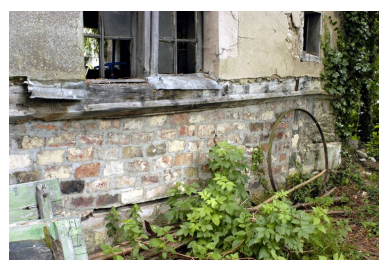
Bâtiment destiné au lavage des laines, détail de l'ancien passage ouvert pour alimenter le lavoir, aujourd'hui obturé. Phot. Thierry Lefébure IVR22_20046000221NUCA
