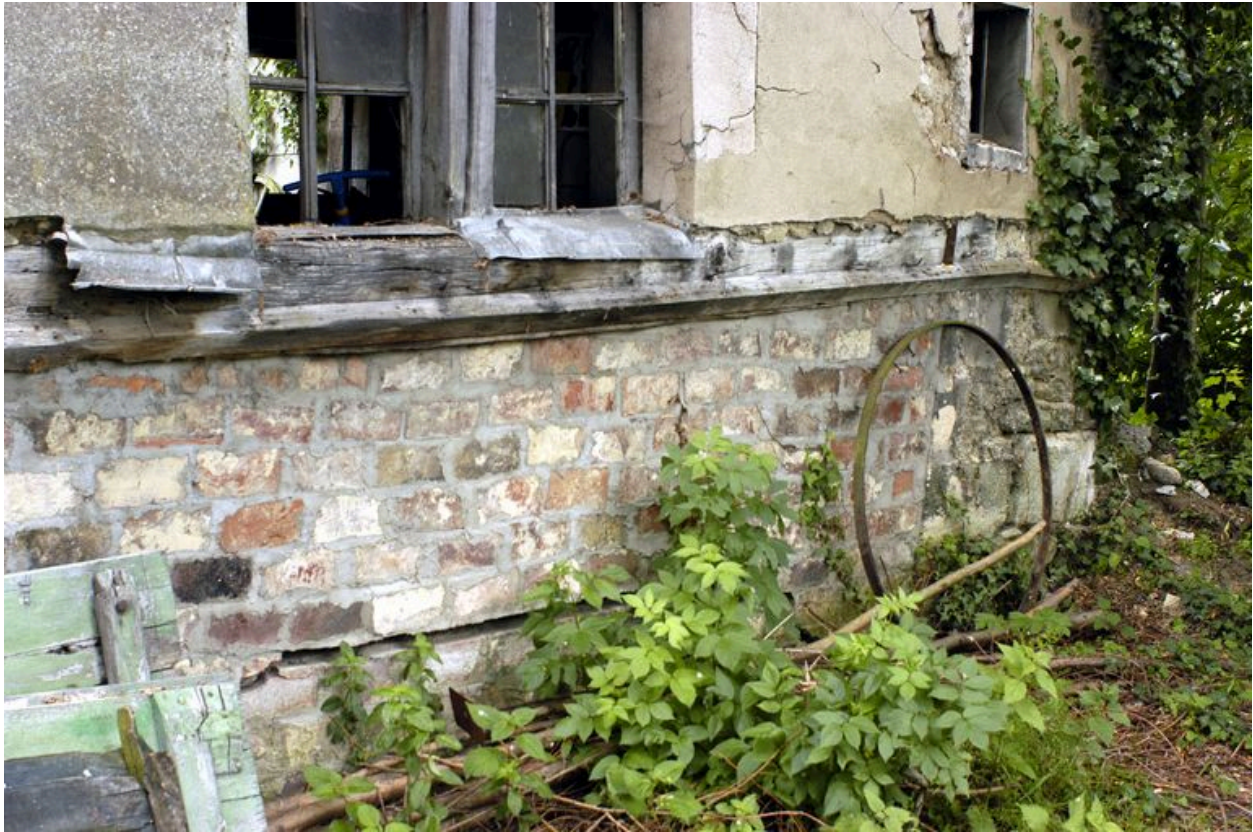
Bâtiment destiné au lavage des laine, détail de l'ancien passage ouvert pour alimenter le lavoir, aujourd'hui obturé.
