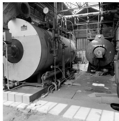
Chaufferie, vue intérieure. Chaudières. Phot. Philippe Dapvril IVR31_19885901248X
