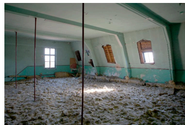
Etage de combles ayant abrité les dortoirs, le voûtement en béton. Phot. Pierre Thibaut IVR31_20135900150NUCA
