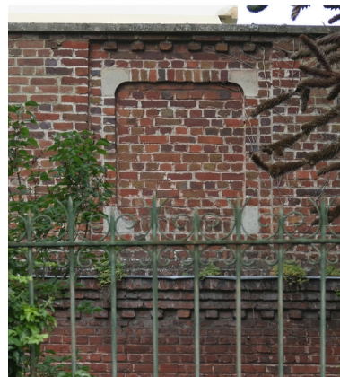
Mur des ateliers bordant le boulevard, orienté vers le jardin du logement patronal. Phot. Frédéric Pillet IVR22_20040200880NUCA
