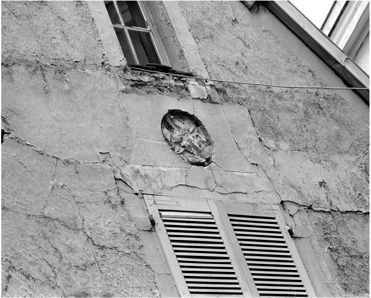
Détail d'un médaillon manquant sur le pignon.
