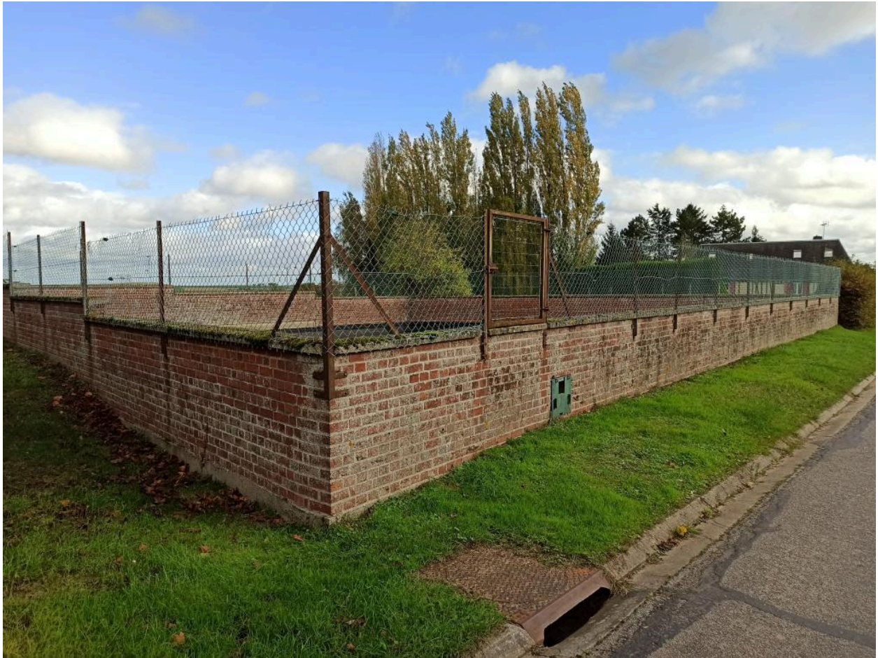
Mare avec murs maçonnés en brique, rue Principale, en face du n°27, vue générale depuis la rue.
