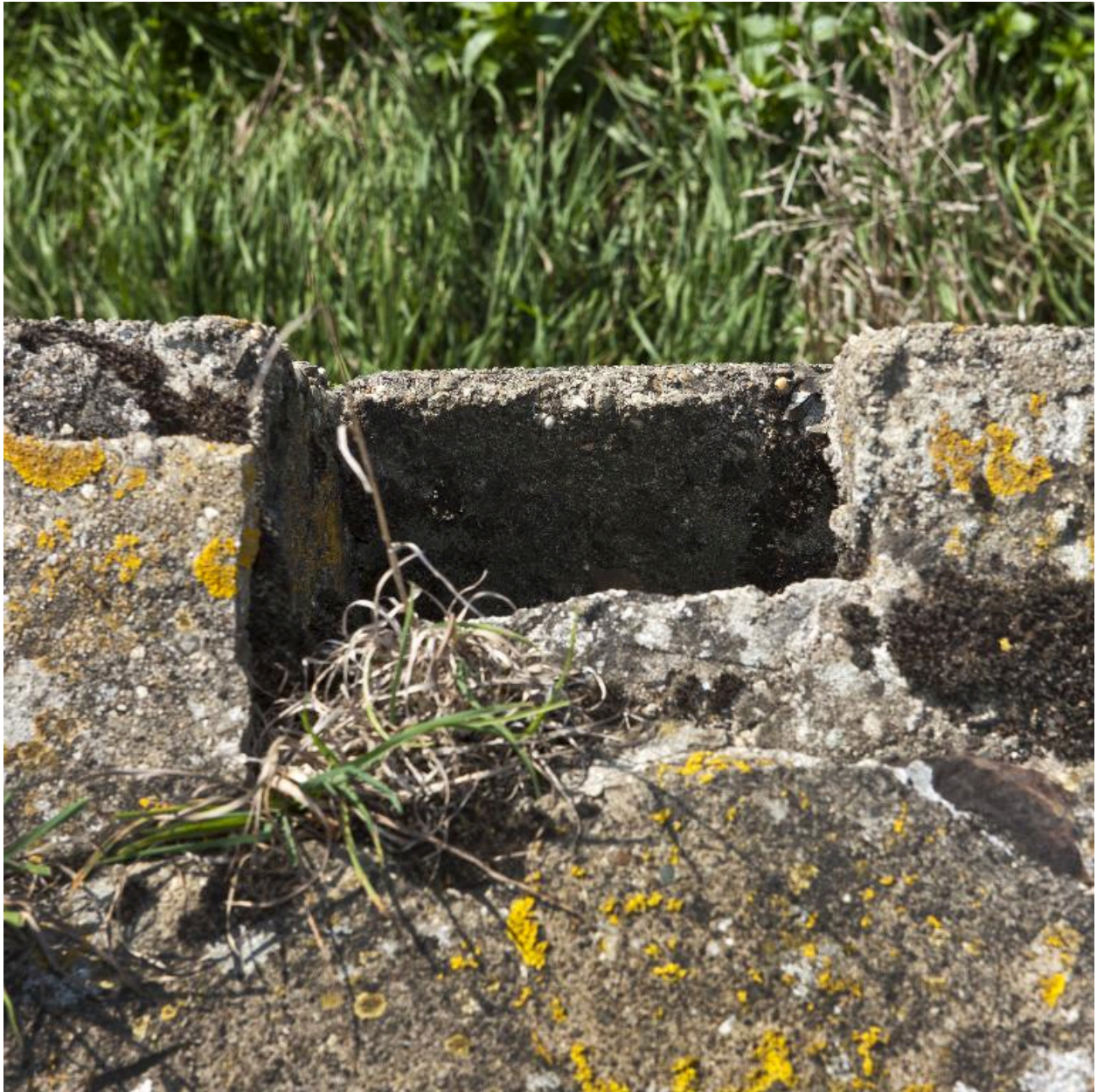
Sortie d'aération de la salle sud-est
