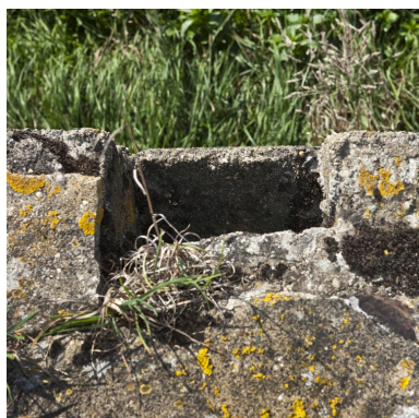
Sortie d'aération de la salle sud-est Phot. Jean-Marc Ramette IVR31_20145904164NUCA
