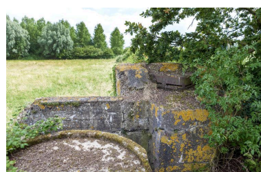
Depuis la plateforme nord-est vers le sud-est. L'observatoire casematé, à droite Phot. Jean-Marc Ramette IVR31_20145904790NUCA
