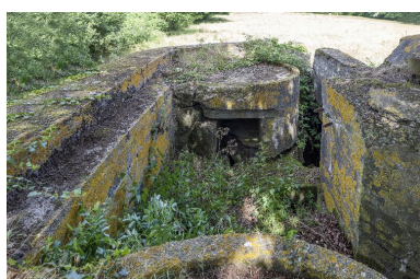
Plateforme à mitrailleuse, en face et conduit d'accès à l'intérieur de l'abris, à droite Phot. Jean-Marc Ramette IVR31_20145904793NUCA
