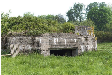
Élévation sud, entrée pour l'artillerie et poste d'observation, à droite sur le couverture Phot. Jean-Marc Ramette IVR32_20165901403NUCA
