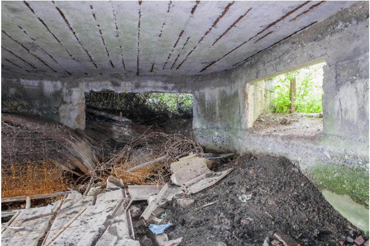
Vue intérieure de la chambre de tir vers le nord. Embrasures de tir
