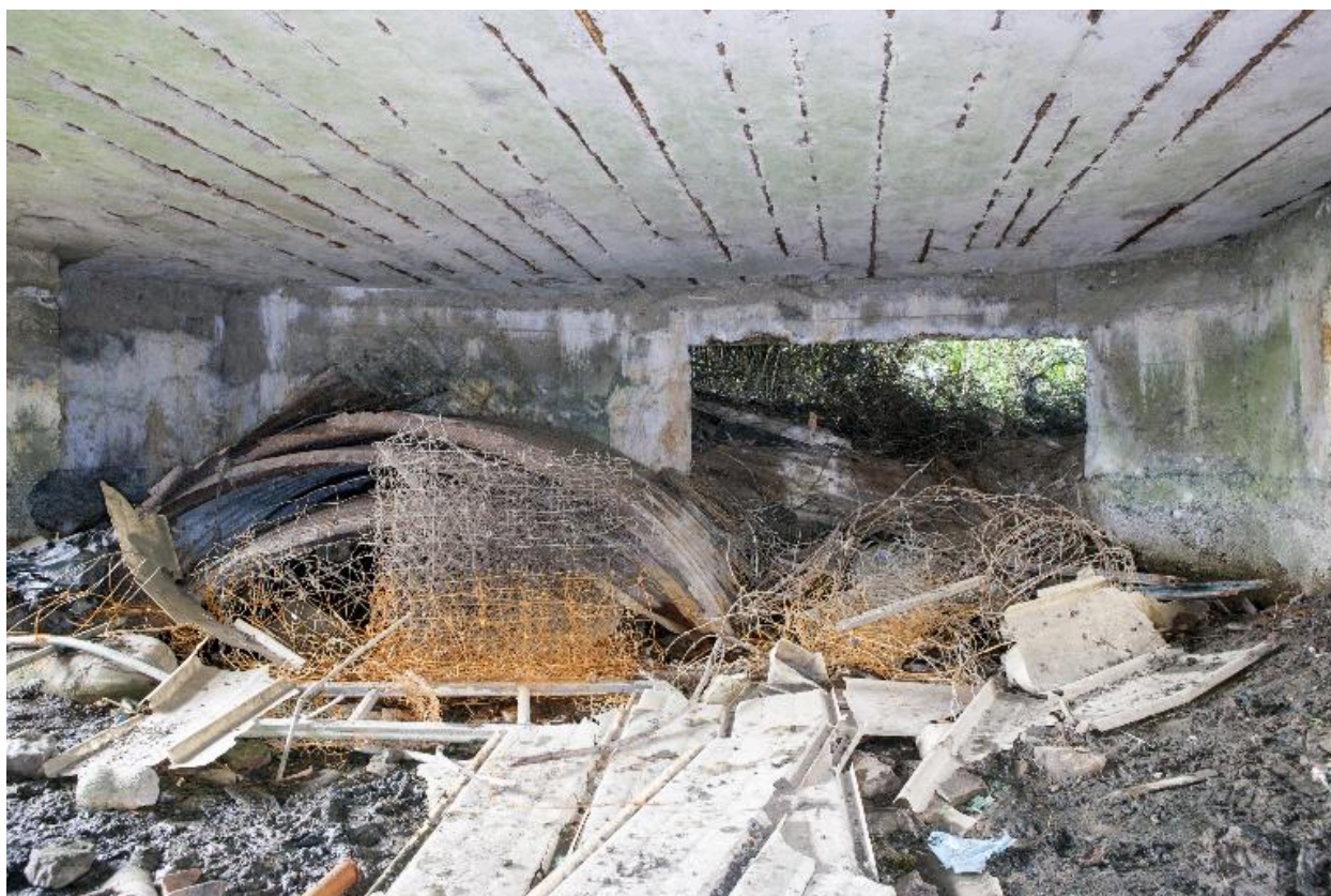
Vue intérieure de la chambre de tir vers l'embrasure de tir ouest
