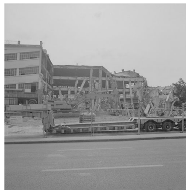
Vue d'ensemble du garage en cours de démolition, le 26 avril 1999. Phot. Thierry Lefébure IVR22_19998000917X
