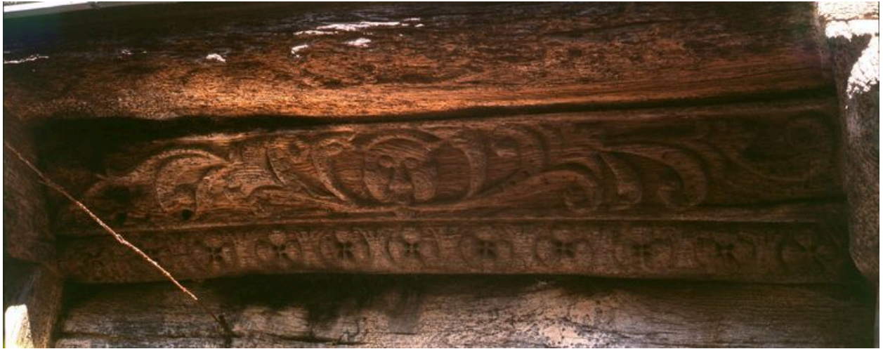
Détail d'une poutre sculptée de la maison Landot, élévation postérieure sur cour.
