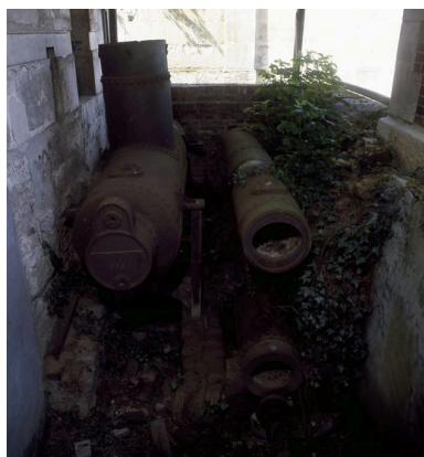
Chaudière tubulaire à deux bouilleurs. Phot. Thierry Lefébure IVR22_20006000645XA
