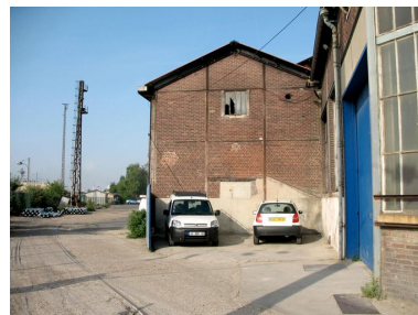
Mur pignon de l'atelier de mécanique et d'ajustage. Phot. Clarisse Lorieux IVR22_20076005373NUCA
