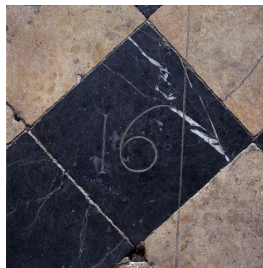
Détail d'un des chiffres indiquant le numéro de la travée des bancs. Phot. Thierry Lefébure IVR22_19990203738XA
