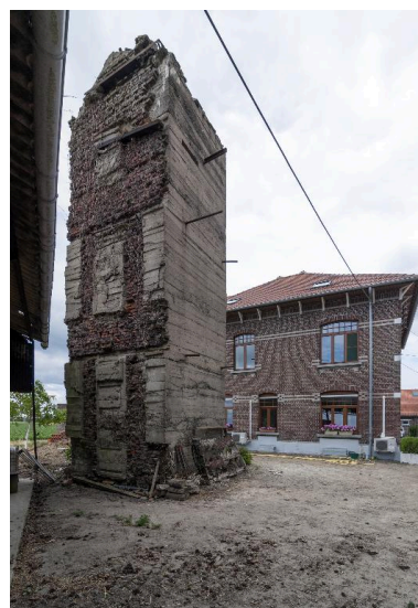
Vue de trois-quarts vers l'est de l'observatoire casematé (A). On remarque l'empreinte des ouvertures de l'ancien colombier ainsi que l'embrasure d'observation au sommet. Phot. Jean-Marc Ramette IVR32_20165901024NUCA
