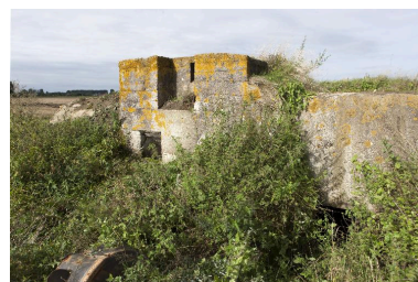
Élévation antérieure. Le poste de tir au centre et, à sa droite, l'entrée dans l'édifice Phot. Jean-Marc Ramette IVR31_20146203054NUCA
