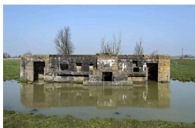
Vue générale, vers le nord. On retrouve les entrées latérales et, au centre, la resserre à mitrailleuse Phot. Jean-Marc Ramette IVR32_20165901004NUCA
