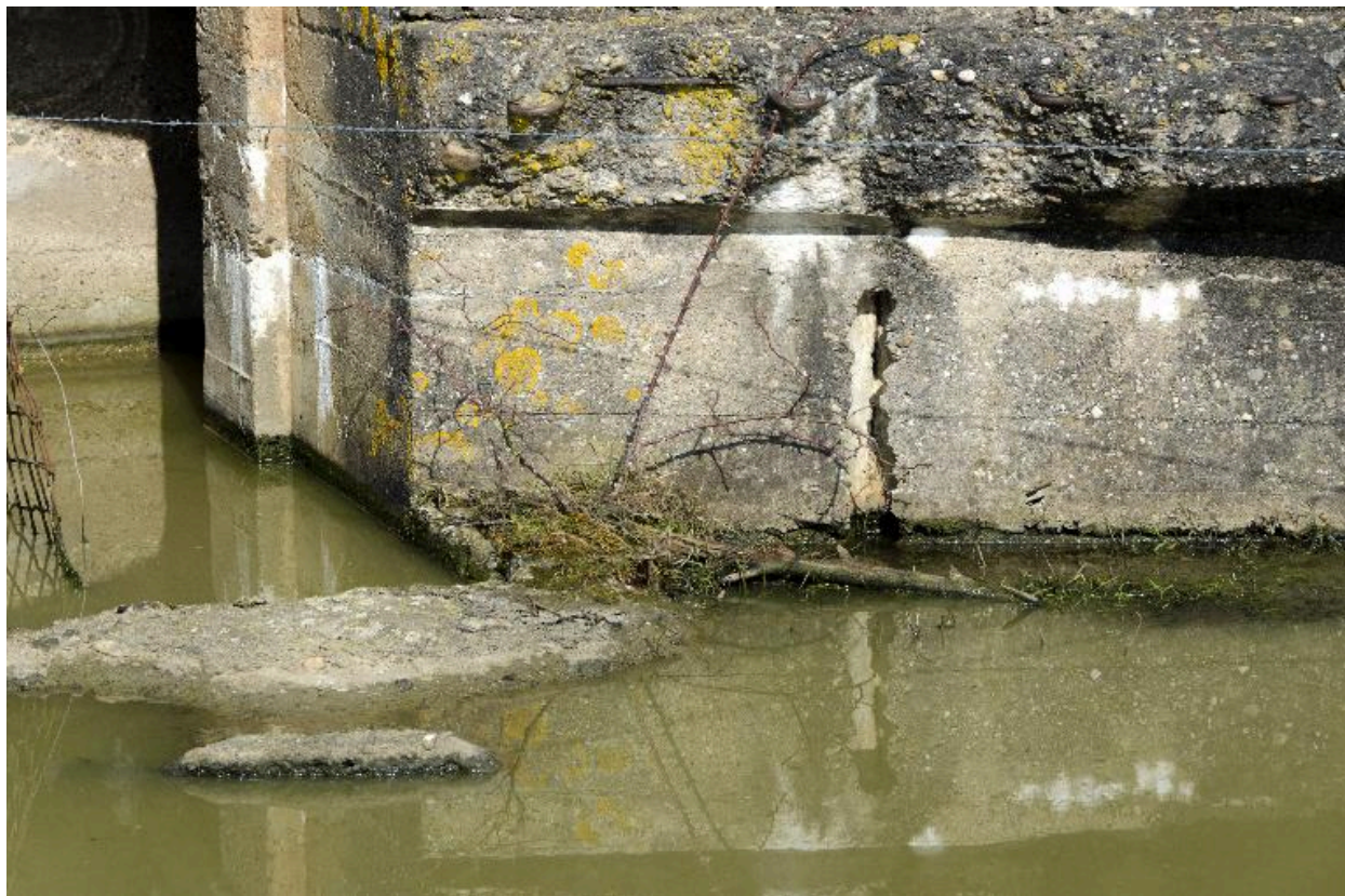
Elévation sur, entrée ouest, empreinte d'un piquet de maintien du coffrage, lors de la construction
