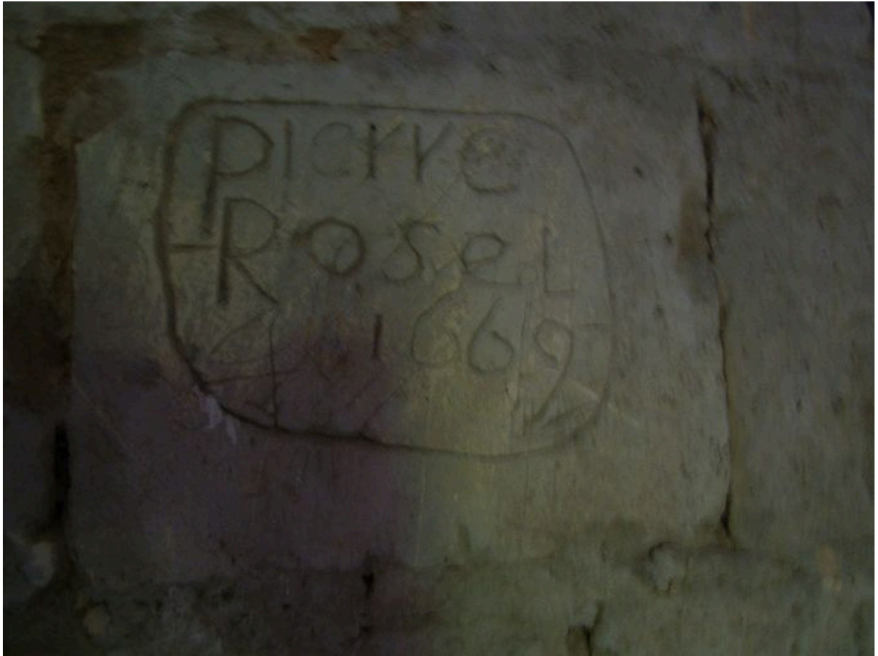
Graffiti sur le mur intérieur du clocher : Pierre Rosel/1669.
