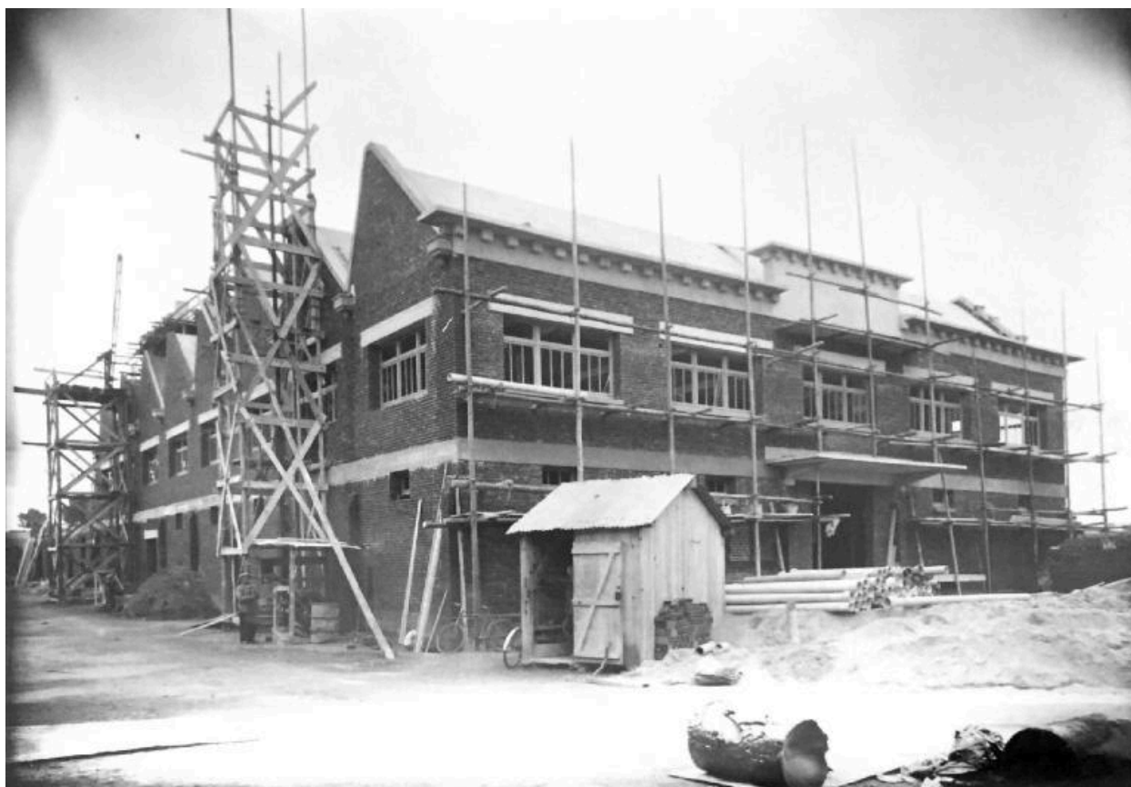
L'entrepôt des matières premières et l'atelier de confection en cours de construction, printemps 1946 (coll. part.).
