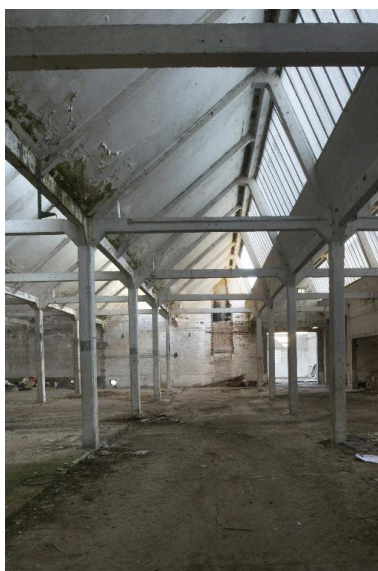
Détail d'une travée en shed de l'atelier de tissage. Phot. Thierry Lefébure IVR32_20168000810NUC2A
