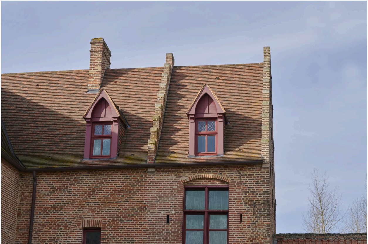
Détails de la toiture couvrant la tour porche et le logis du XVIe siècle.
