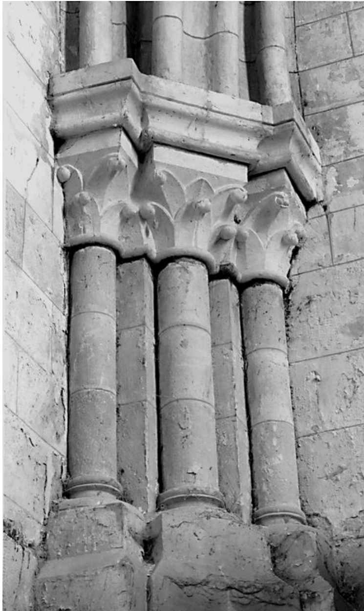
Transept nord : détail des faisceaux de colonnes supportant le départ des voûtes d'ogives.
