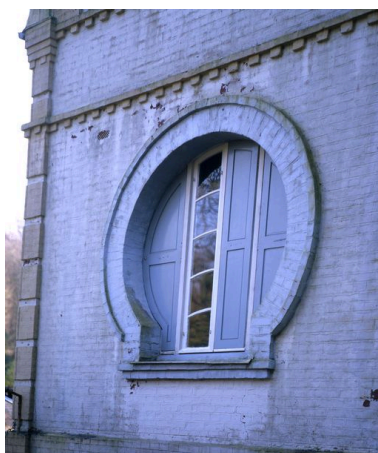
Détail de la baie de la façade latérale droite. Phot. Marie-Laure Monnehay-Vulliet IVR22_20058000146XA
