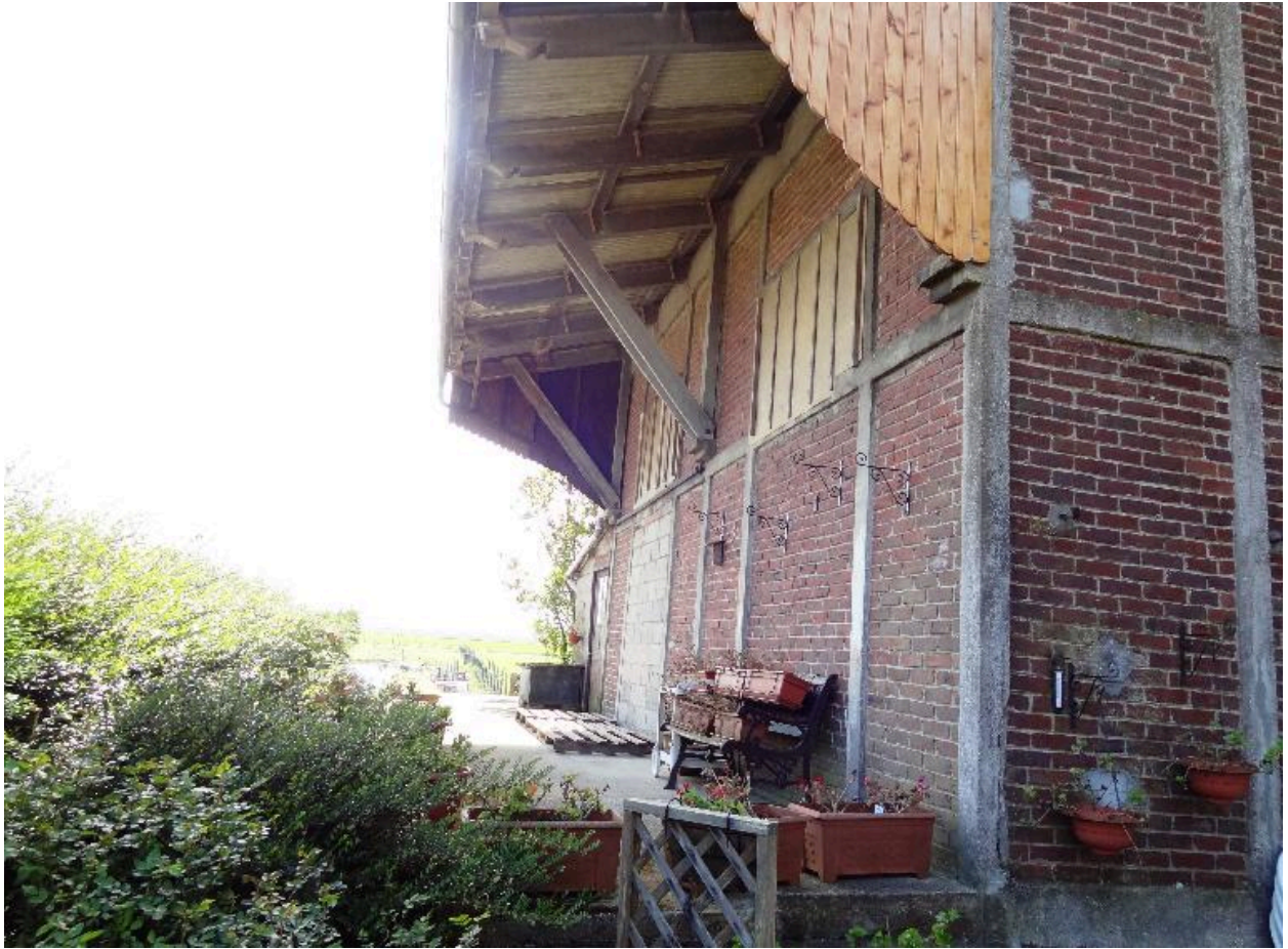
Vue actuelle de l'ancien quai et de l'ancien hangar de la gare de Saint-Quentin-la-Motte-Croix-au-Bailly.
