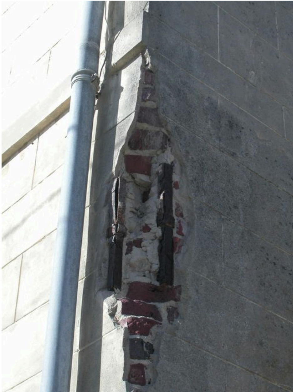
Détail d'une chaîne d'angle dégradée.
