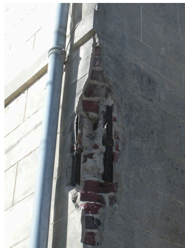
Détail d'une chaîne d'angle dégradée. Phot. Elisabeth Justome IVR22_20058002713NUCA
