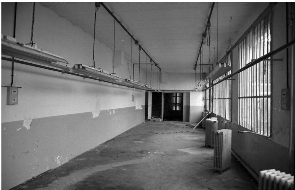
Vue intérieure de l'atelier de fabrication.
