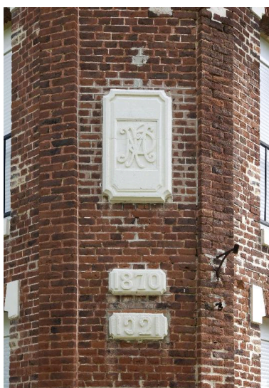
Cartouche en pierre portant les Initiales M et P entrelacées et les dates 1870 et 1921, sur le pan coupé extérieur de la propriété. Phot. Thierry Lefébure IVR22_20160200112NUC2A
