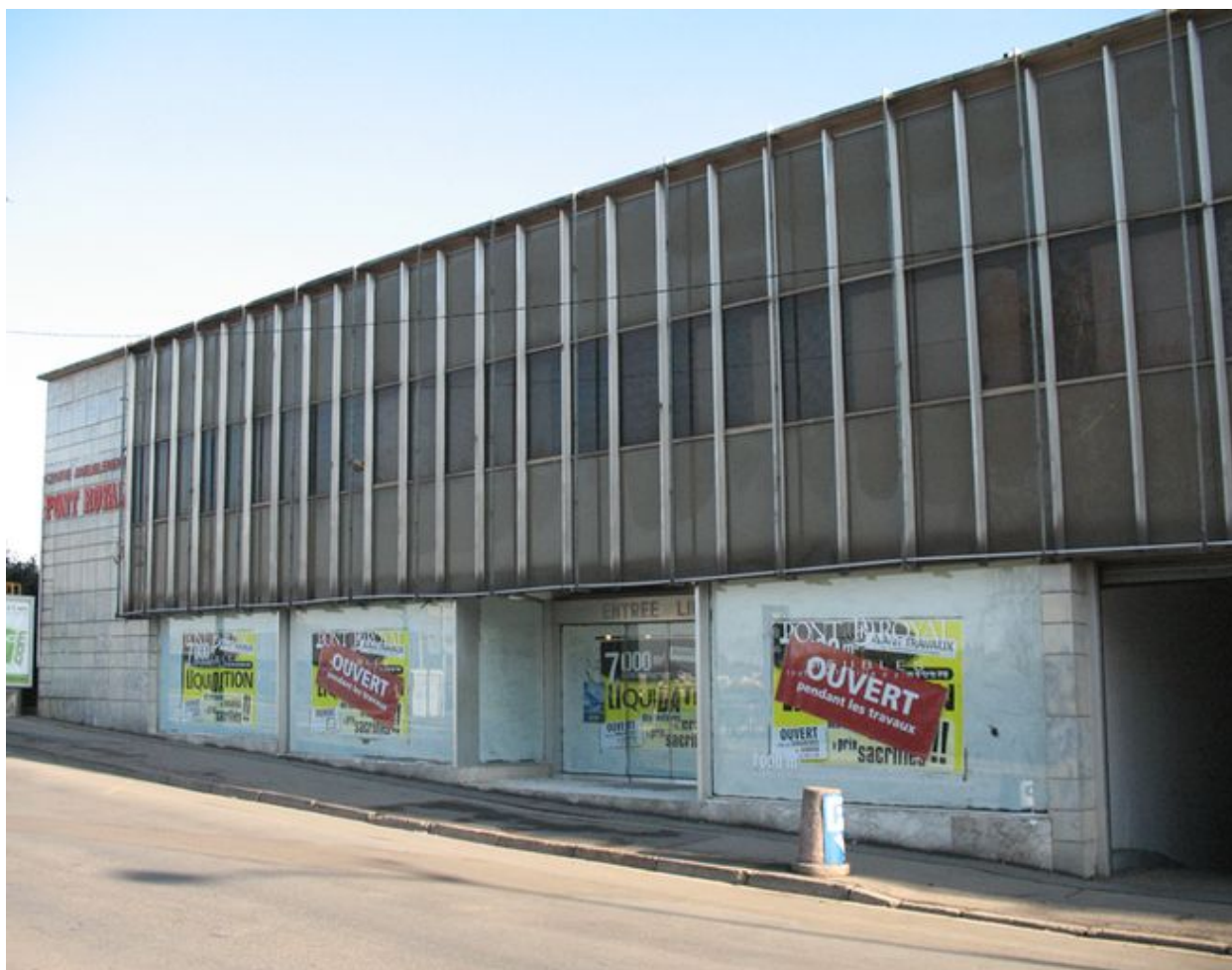
Détail de la structure verre et fer de la façade sur la rue Gambetta en février 2009.
