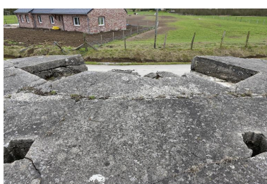
Depuis le toit, vers le sud, les sorties des cheminée à périscope et les encuvements des armes Phot. Jean-Marc Ramette IVR31_20145904065NUCA
