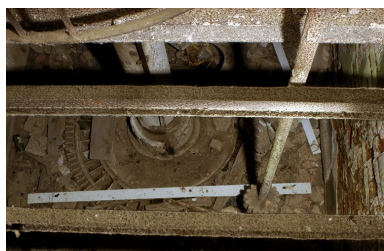
La partie supérieure de la turbine du moulin. Phot. Thierry Lefébure IVR22_20056000068NUCA
