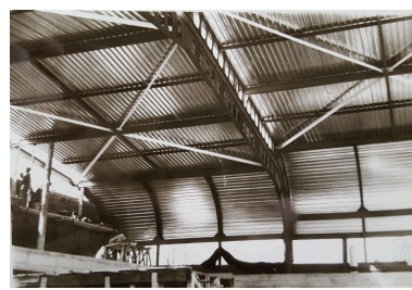
Détail de l'intérieur de la structure mobile. Vue de chantier. Juillet 1967. Photo : Société MacGregor-Comarain (AN ; 19840036/145). Phot. Laurence Schlosser (reproduction) IVR32_20176005033NUCA
