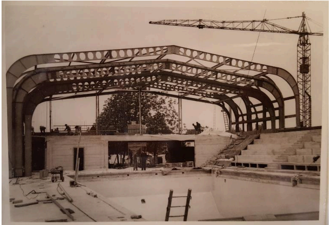
Photo de la piscine en construction, pignon ouest, juin 1967. Photo : société MacGregor-Comarain (AN ; 19940528/1).
