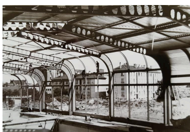
Vue de la structure mobile depuis l'intérieur de la piscine en travaux. Juillet 1967. Photo : Société MacGregor-Comarain (AN ; 19840036/145). Phot. Laurence Schlosser (reproduction) IVR32_20176005035NUCA
