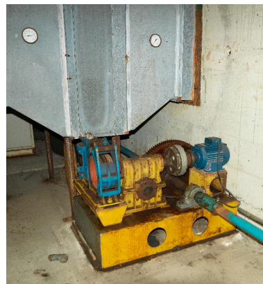
Moteur de la structure mobile. Phot. Marie-Laure Monnehay-Vulliet IVR32_2017600013NUC2A
