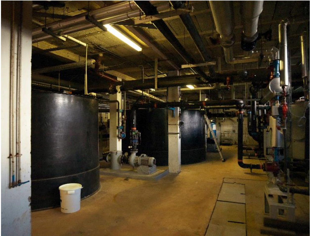
Vue générale de la machinerie : les cuves de filtration.
