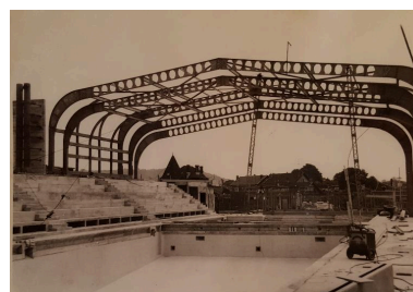
Photo de la piscine en construction, groupe des trois éléments (1 fixe et 2 mobiles) côté Est, juin 1967. Photo : Société MacGregor-Comarain (AN ; 19940528/1). Phot. Laurence Schlosser (reproduction) IVR32_20176005020NUCA
