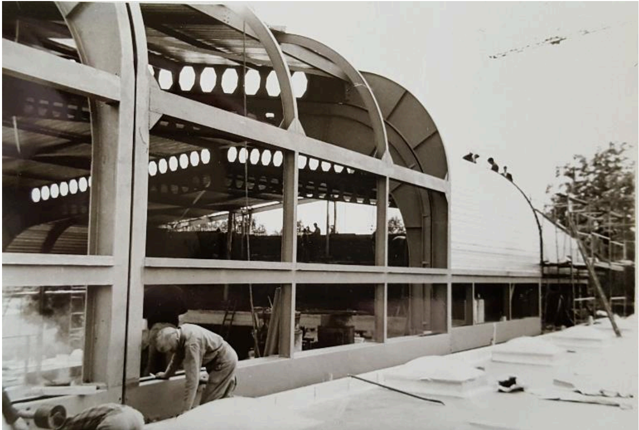
Détail de la structure mobile depuis l'extérieur. Vue de chantier. Juillet 1967. Photo : Société MacGregor-Comarain (AN ; 19840036/145).
