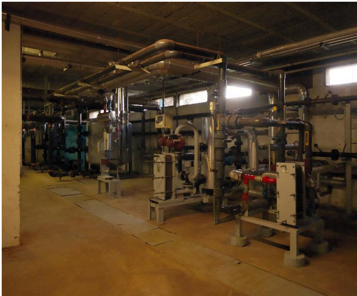
Vue générale de la machinerie (entièrement rénovée en 1992-1993).
