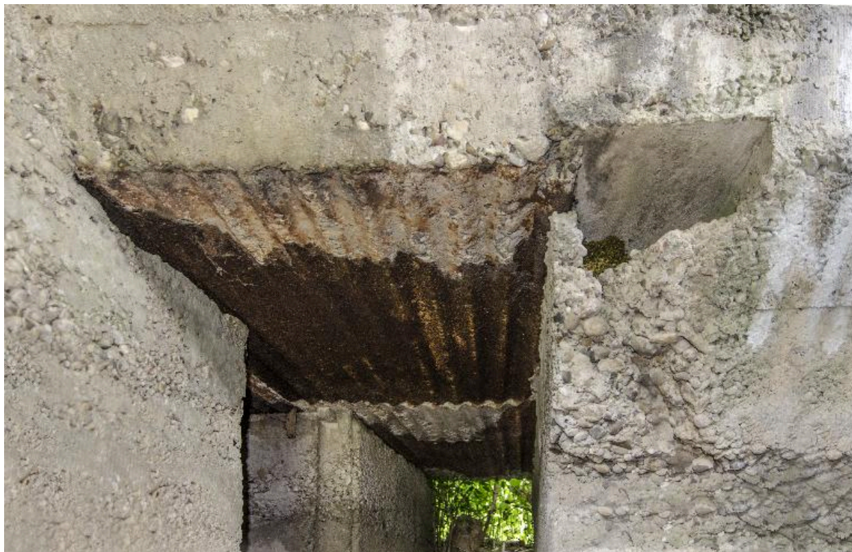
Couloir de distribution, détail du plaquage en tôle ondulée (au grand angulaire)
