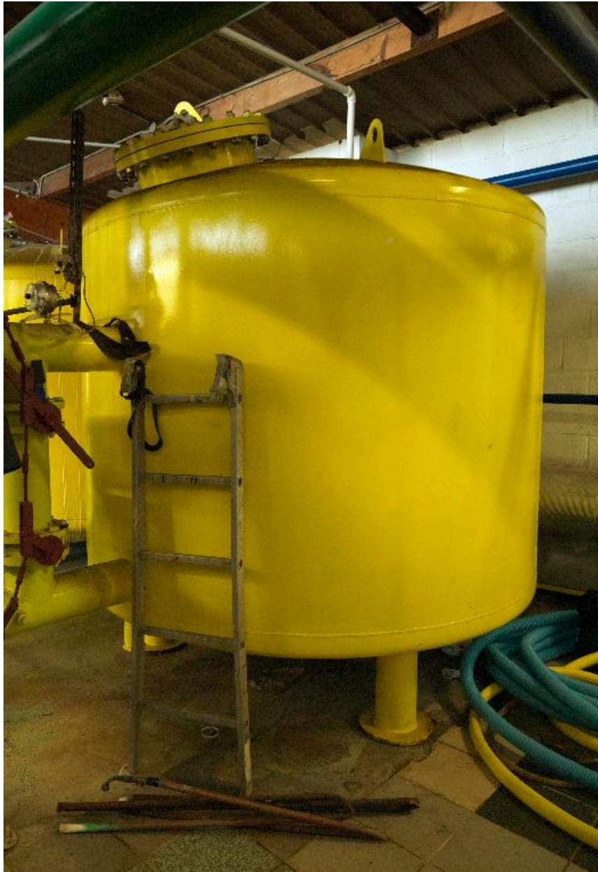
Local technique : cuve de filtration.
