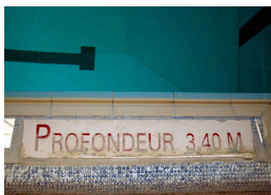
Détail de la margelle du grand bassin, profondeur maximale : 3,40 mètres. Phot. Marie-Laure Monnehay-Vulliet IVR32_20170200327NUC2A
