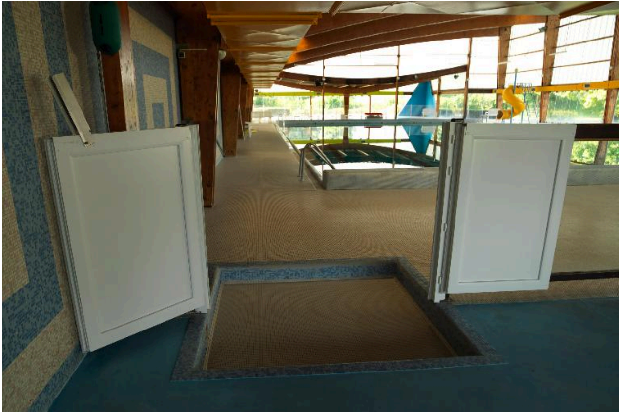
Pédiluve d'accès entre les bassins et le "foyer".
