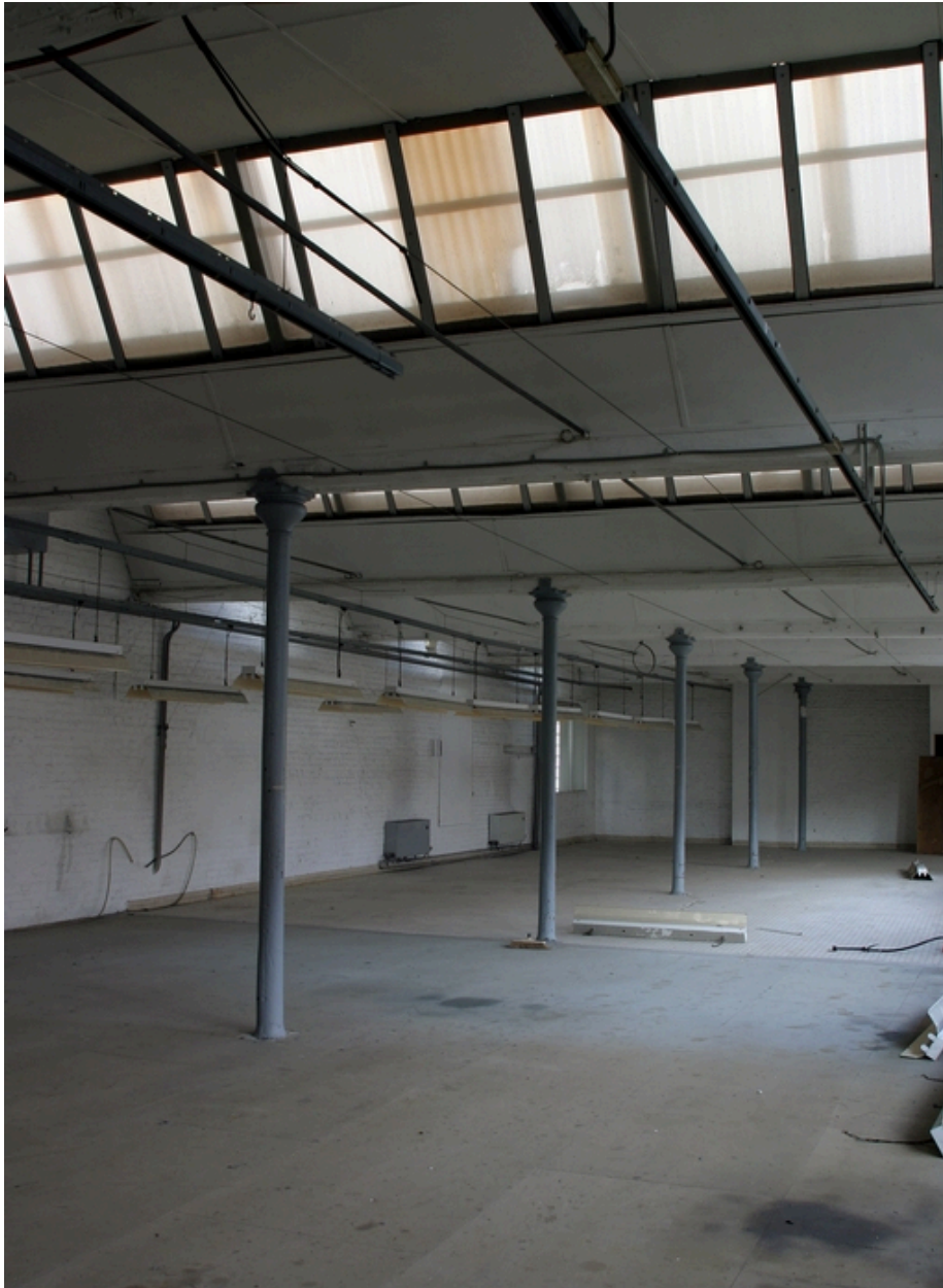
Etage des ateliers antérieurs à 1900 (ensemble ouest) : colonnes en fonte et sheds.
