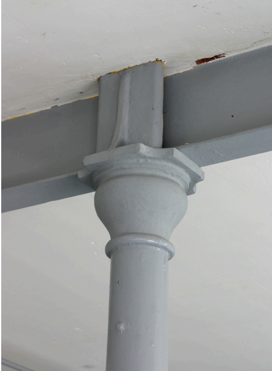
Ateliers antérieurs à 1900 (ensemble ouest) : chapiteau d'une colonne en fonte du rez-de-chaussée.
