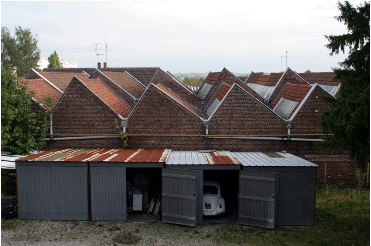
Vue des sheds couvrant les anciens ateliers d'ourdissage, de piquage des cartons, etc, construits avant 1900 et restaurés en 1919.
