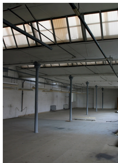
Etage des ateliers antérieurs à 1900 (ensemble ouest) : colonnes en fonte et sheds. Phot. Frédéric Pillet IVR22_20040201036NUCA
