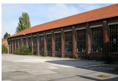
Façade occidentale de l'un des deux grands ateliers de guipure reconstruits à partir de 1919. Phot. Frédéric Pillet IVR22_20040201047NUCA
