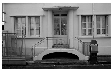
Les bureaux : détail de l'entrée et du garde-corps en ferronnerie portant les initiales ACC. Phot. Benoît Dufournier IVR22_19936002458Z
