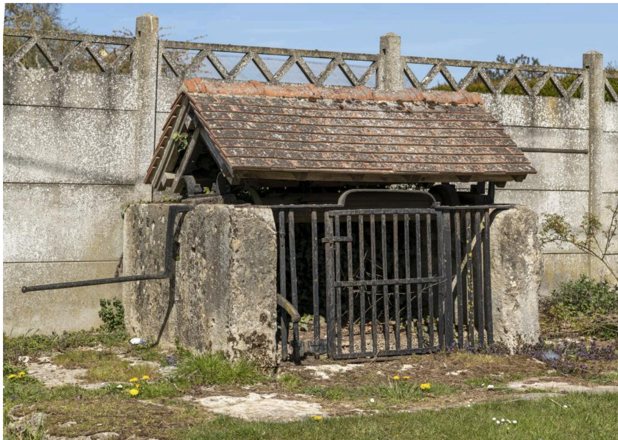
Ancien puits sous la forme d'un édicule architecturé (a certainement perdu son toit fait de deux blocs de calcaire), rue Principale en face de la mairie-école.
