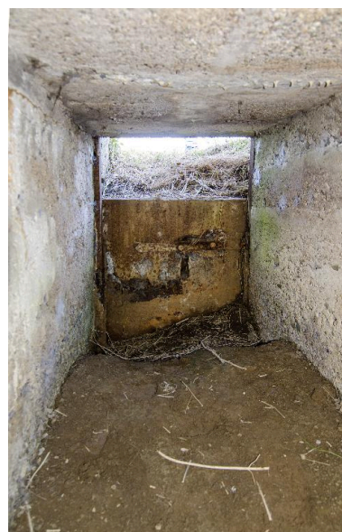
Vue intérieure du porche pare soufflé. L'un des deux accès. Phot. Jean-Marc Ramette IVR32_20175900994NUCA
