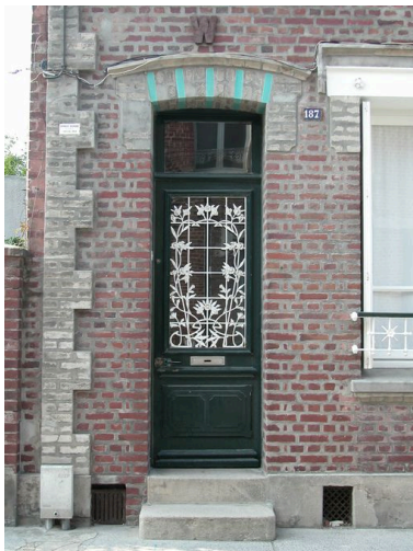
Détail de la porte et de sa grille en fonderie. Phot. Elisabeth Justome IVR22_20058003628NUCA
