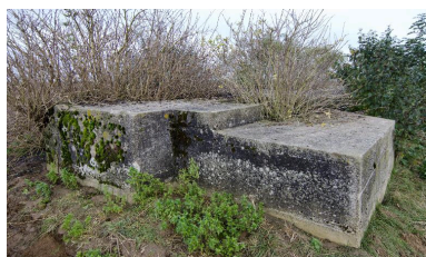
Angle sud-ouest vers l'est. La partie droite abrite l'observatoire cuirassé nord Phot. Jean-Marc Ramette IVR32_20176200546NUCA
