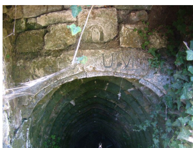
Entrée d'une cave ancienne, 7 rue des Bons Enfants. Phot. Inès Guérin IVR22_20030202484NUCA
