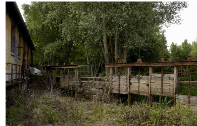
Vannage de décharge du canal d'amenée. Phot. Thierry Lefébure IVR22_20046000198NUCA
