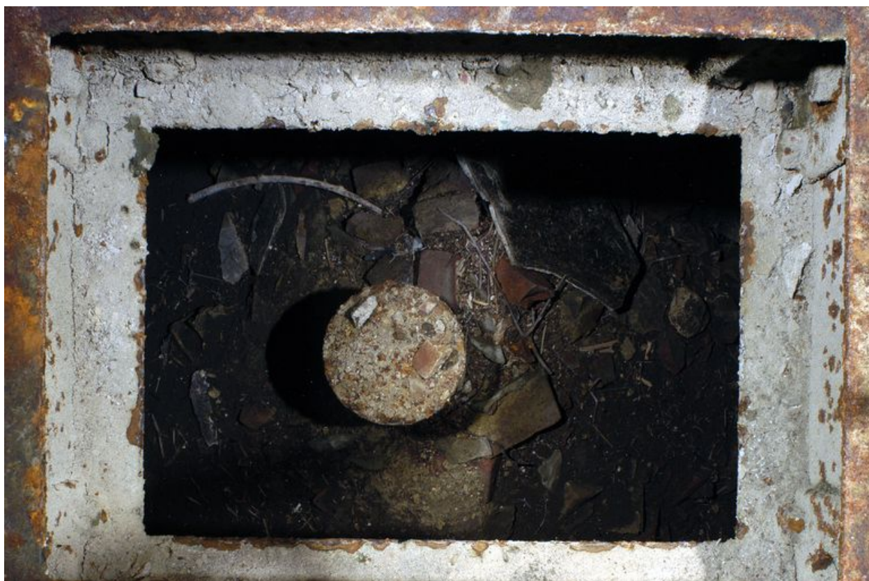
La turbine hydraulique, vue de dessus.
