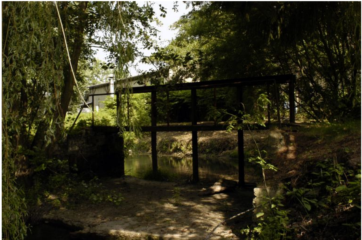
Vannage de décharge principal et déversoir.
