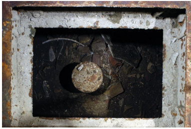
La turbine hydraulique, vue de dessus. Phot. Thierry Lefébure IVR22_20046000195NUCA
