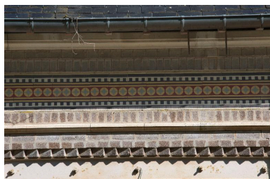
Détail de la frise polychrome de la dépendance. Phot. Thierry Lefébure IVR22_20148000443NUC2A
