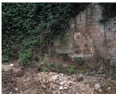
Ancienne habitation troglodytique murée et envahie par la végétation, chemin du Stand à Creil. Phot. Thierry Lefébure IVR22_20076000086XA
