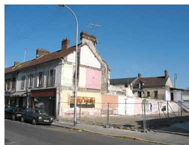
A la faveur de la démolition d'un pâté de maisons en avril 2007, la maison de Prosper Désiré Dessens, entrepreneur de maçonnerie révèle une inscription sur la souche de la cheminée. Phot. Clarisse Lorieux IVR22_20076005469NUCA
