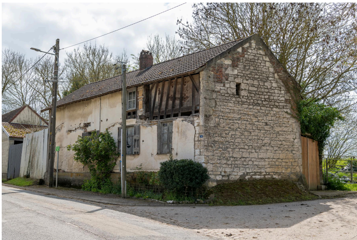
Logis en torchis et pan de bois, n°4 de la Grande Rue, vue prise depuis le nord.
