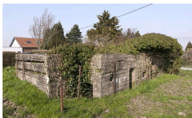
Vue vers nord-est. L'entrée latérale et les deux entrées antérieure Phot. Jean-Marc Ramette IVR31_20145905346NUCA
