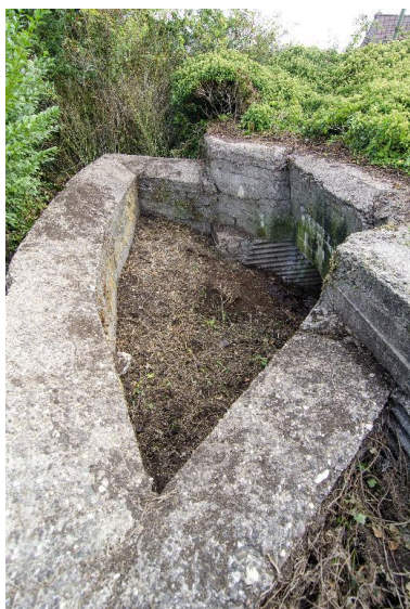
Elévation nord, la cuve à canon (au grand angle) Phot. Jean-Marc Ramette IVR32_20165901525NUCA
