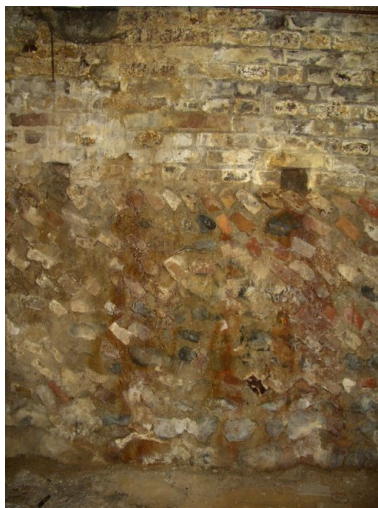
Vue des fondations visibles depuis l'intérieur de la cave. Phot. Inès Guérin IVR22_20068005171NUCA
